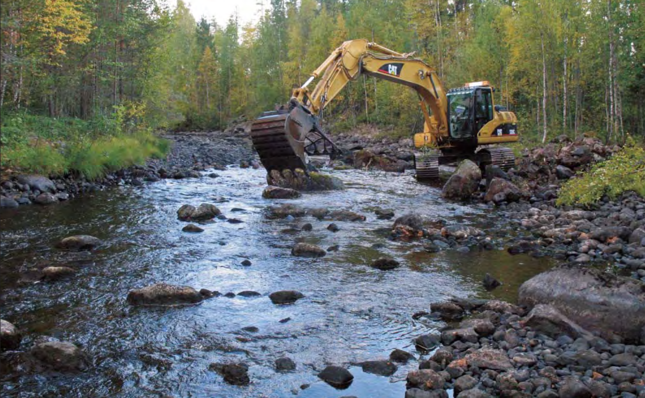
Restaureringsarbete i Manjaurån. Med hjälp av grävmaskin återförs stenmaterial till det tidigare flottledsrensade vattendraget. Foto: Roger Vallin.
