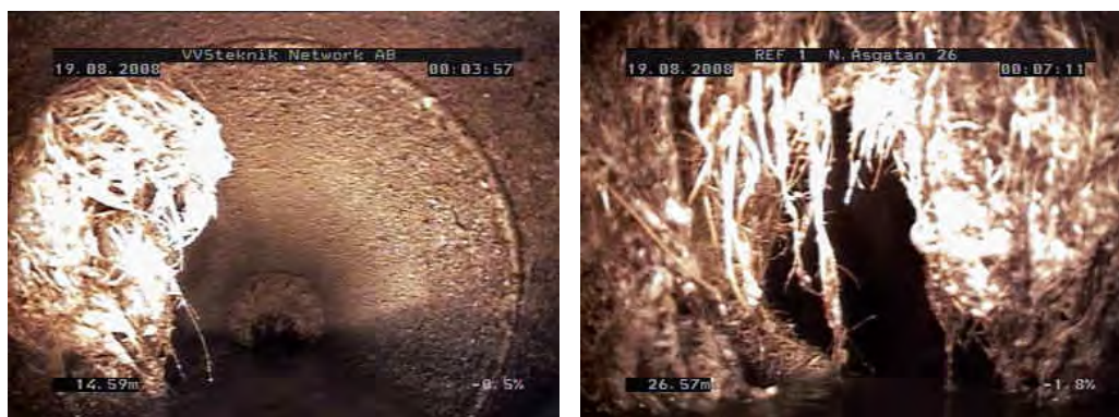
Figur 1. Rotinträngning i spillvattenledning i Ockelbo kommun. Röret är 300 mm i diameter. Bilderna kommer från en filmsekvens som togs i samband med inventering i augusti 2008 och publiceras med tillstånd från Ockelbo kommun.
